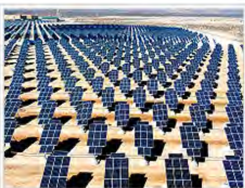
Nellis Solar Power Plant, 14 MW power
